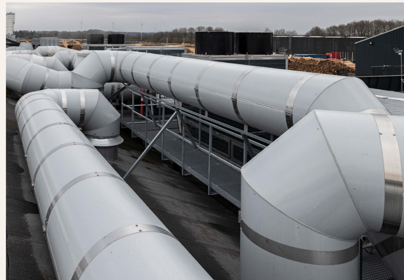
Troldekt har udvidet et pilotforsøg med varmegenvinding i vores tørreproces ved at installere yderligere syv varmevekslere. De ekstra varmevekslere kan potentielt reducere vores brændselsbehov med omkring 20 procent. Læs mere på side 28.
